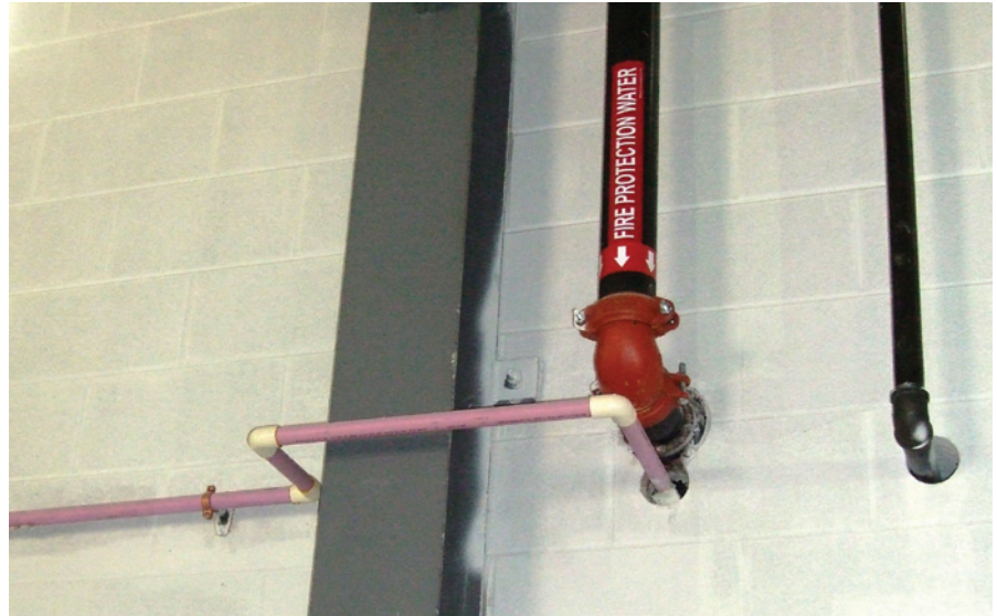
Purple pipe.jpg "Courtesy Mike Cudahy"
